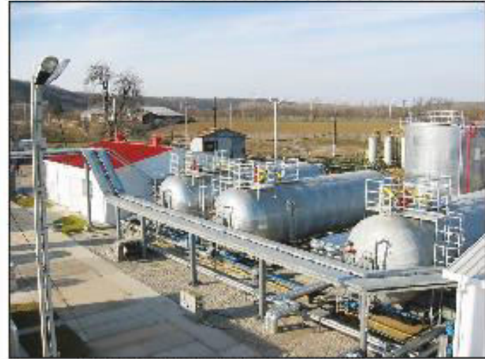
15 Bis Vata Separation Installation
