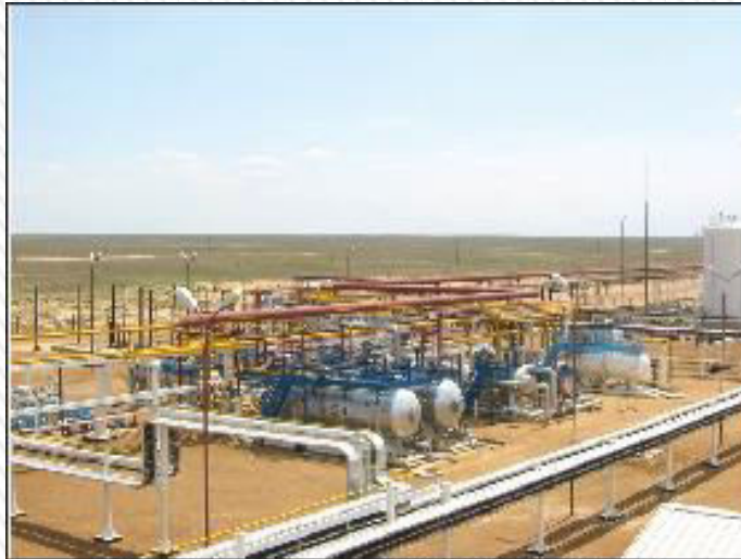
UKPG gas/condensate separators
